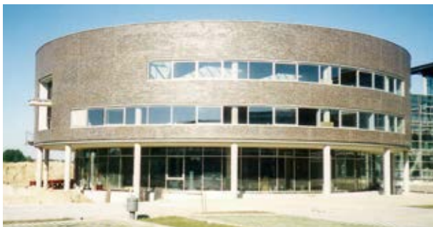
Beim Gütersloher Kreishaus war der Rohbau mit überwiegend polygonalen Flächen zu erstellen. Polygonal areas predominated in the carcassing work for the Gütersloh County Seat.
