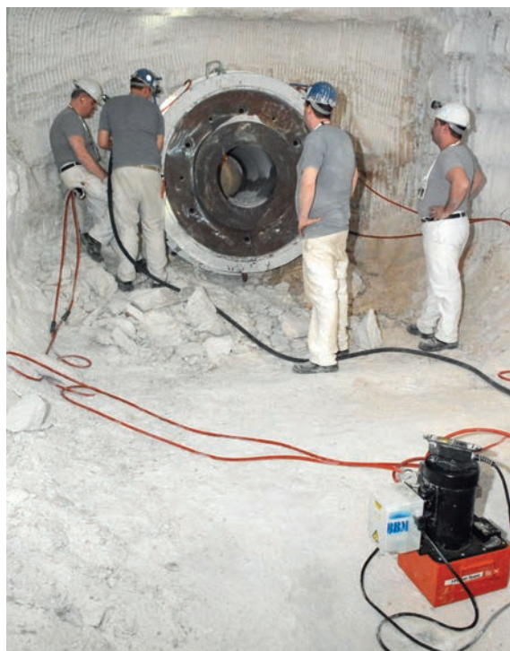
Vier hydraulische Pumpen werden angeschlossen. Sie sollen durch Abdrücken vom Salz die Segmente voneinander lösen.
